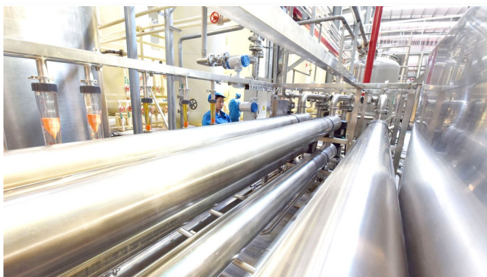
漯河源隆生物科技有限公司低聚木糖生产车间
