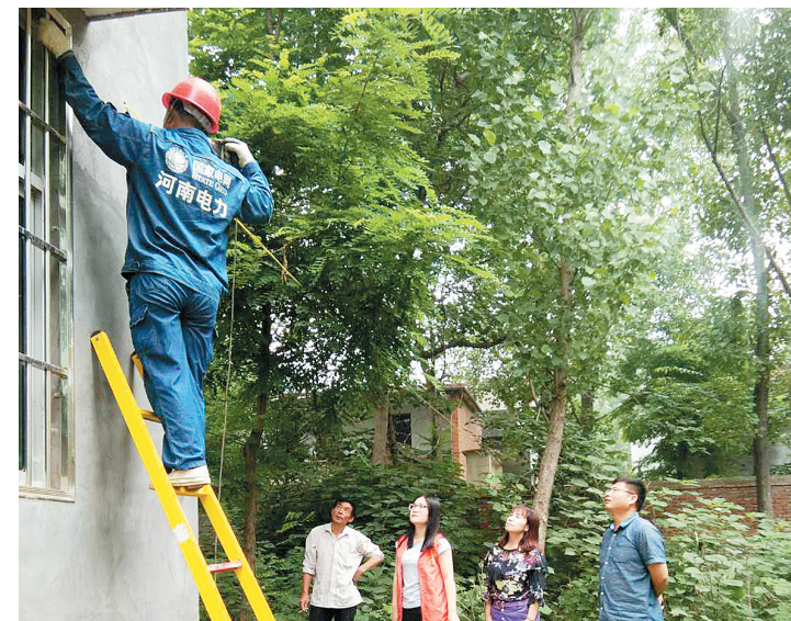
近日,召陵区市场发展中心协调青年镇供电所,为该镇侯庄村贫困户侯早英家安装了用电线路及智能电表,解决其用电问题。
