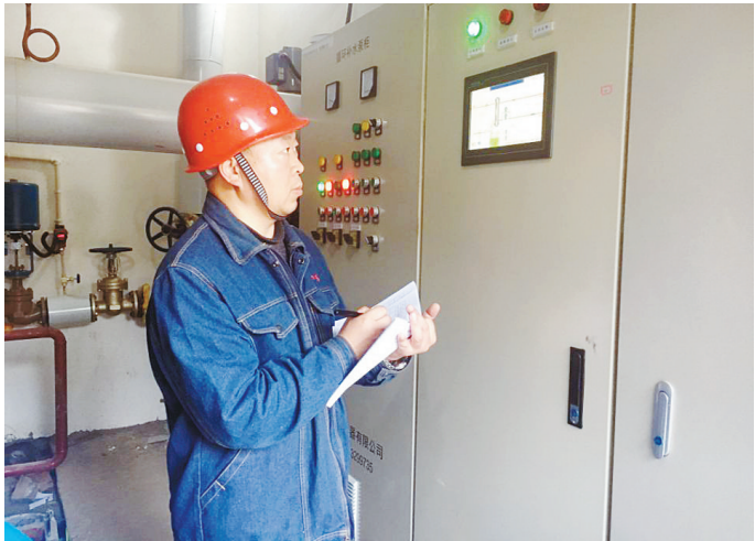
为保证黄山路14家单位安全稳定用热，漯河天阳供热公司派人每天不低于五次巡视各单位换热站，并及时填写换热站设备的运行参数。图为12月24日，工作人员正在巡视换热站，做好运行记录。
