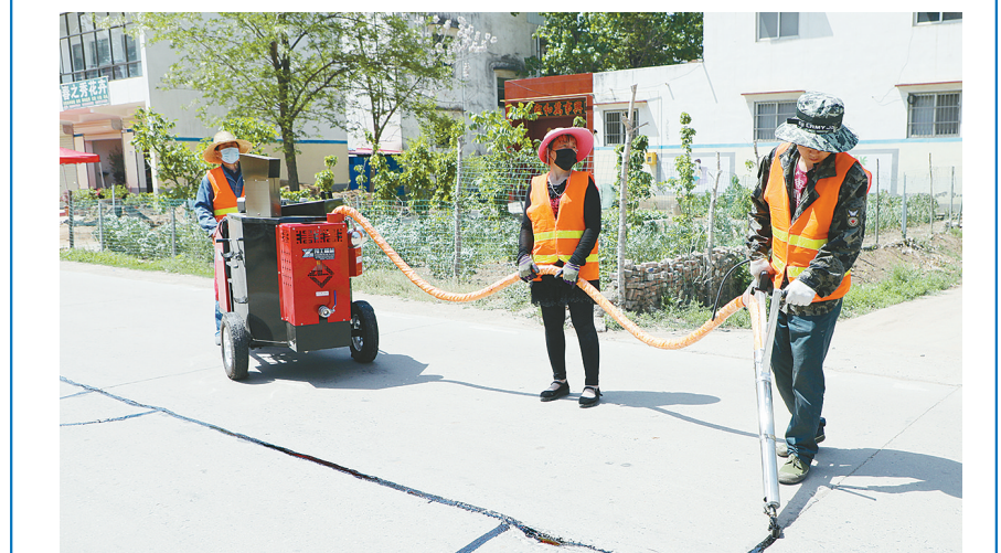
4月25日,李深路上,道路养护工人在修补道路裂缝。据了解,4月份以来,市公路建设和养护中心将农村公路集中养护工作与垃圾清理相结合,对全市农村公路进行集中养护,同时积极排查隐患。 本报记者 范子恒 摄
