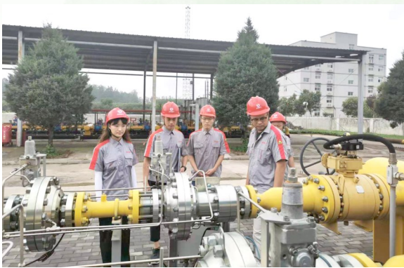
天然气门站安全检查
