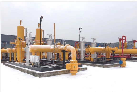
天然气高中压调压站
