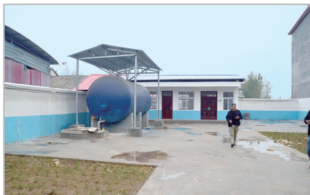
巩固提升后的贫困村饮水工程。
