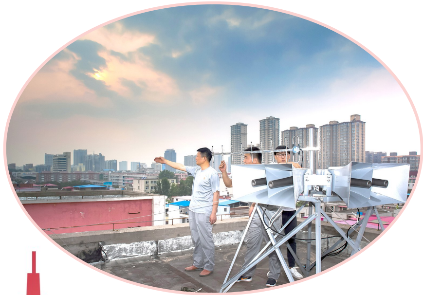
检查检修防空警报器
