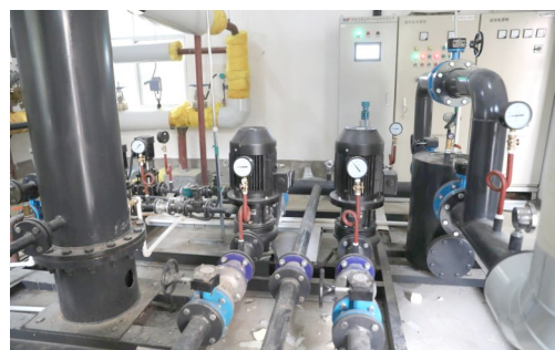
换热站内部运行情况。
