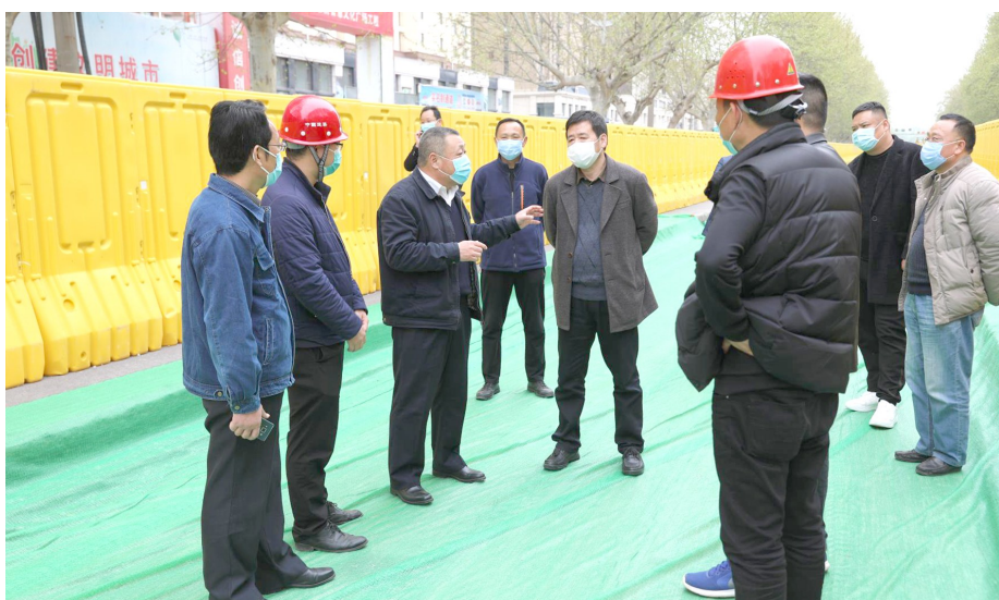
市住建局领导带队在湘江路和文化路交叉口集中供热工地察看施工情况。
