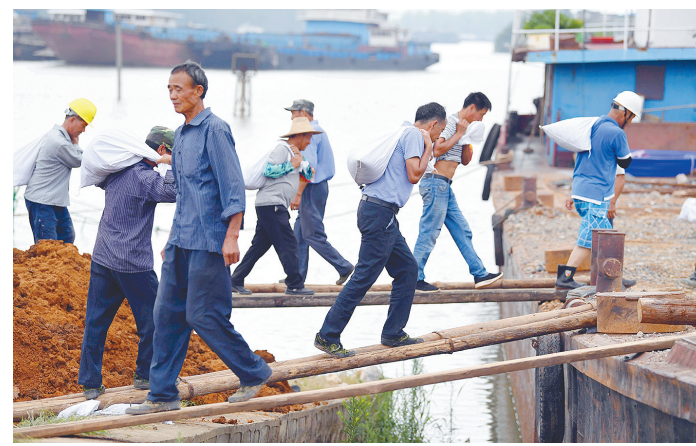
近日,受洪水影响,安徽省望江县华阳镇境内的江调圩内部道路漫水,抢险车辆无法进入。当地防汛部门组织船只装载砂石袋等防汛物资,运往圩堤保防汛。图为7月14日,当地村民往船只上搬运砂石袋。 新华社发
