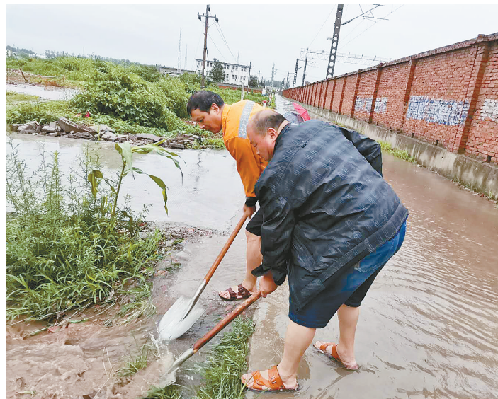
7月21日夜间起,我市突降大雨,漯河火车站运转车间应急小分队对堵塞严重的排水口进行清理,确保铁路畅通。 周云龙 摄
