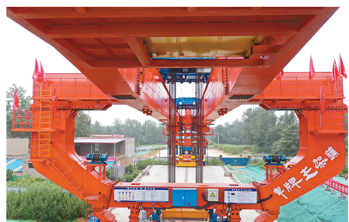
这是8月5日拍摄的正在架设中的郑许市域铁路全线首孔箱梁(无人机照片)。
