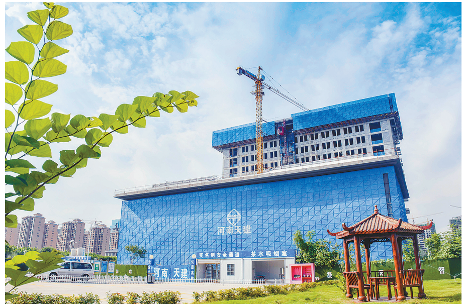
召陵区中医院项目是全市重点项目,位于黄河东路北边,总投资1亿元。目前,项目4层门诊楼、12层病房楼主体全部封顶,正在进行室内墙体砌筑、内外墙体粉刷等配套设施建设。项目建成投用后,将提升召陵区医疗卫生服务水平。 本报记者 张佩攝
