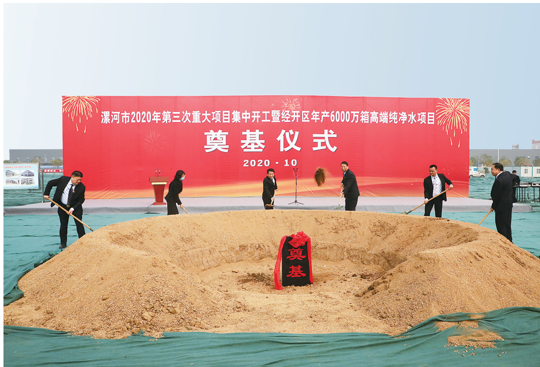
10月30日,全市第三次重大项目集中开工暨经开区景田公司年产6000万箱高端纯净水项目奠基仪式举行。
