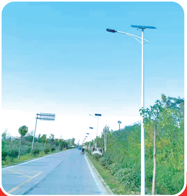
李源路、中原路、纬八路8公里400余盏路灯投入使用。
