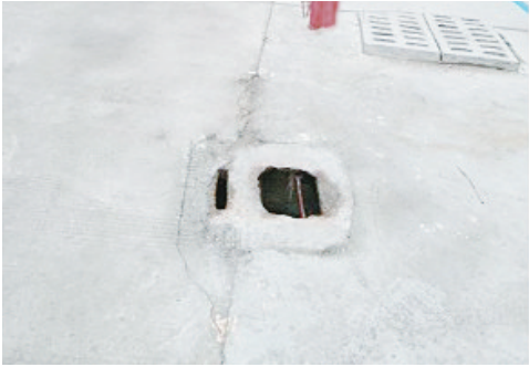
黄山路与辽河路交叉口南,市三院家属院内雨水篦子破损。
