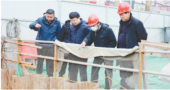
市住建局相关负责人到源汇区柳江路向西五十米路南的热力管网建设工地检查。 宋文琦 摄
