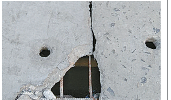
建设路与牛行街交叉口宏泰家园小区,一个井盖破损。
