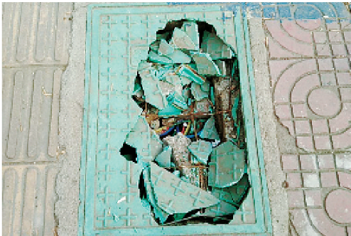
湘江东路与解放南路交叉口向东约120米路北，窞井盖破损。
