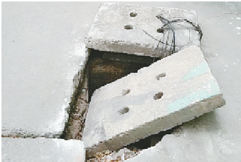
辽河路与舟山路交叉口向西约20米路北，窞井盖移位。
