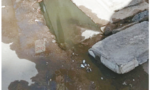
黄河中路与邙山路交叉口附近,下水道堵塞。
