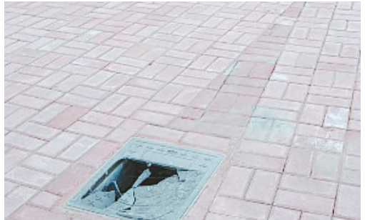
中山南路与湘江东路交叉口附近,井盖破损。
