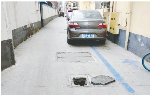
泰山路与民主路交叉口安居工程十号楼，下水道盖子损坏。
