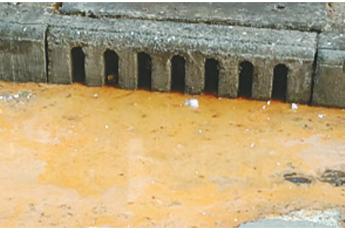
珠江路与金山南路交叉口向西60米路北，田田造型门前下水道堵塞。
