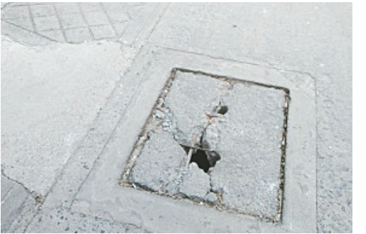
文景路与嵩山南路交叉口向东50米路南，污水井盖破损。
