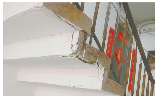
交通路宏运集团376号院4号楼,楼梯严重损坏。
