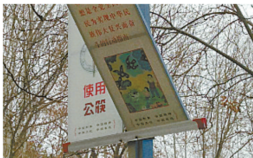
滨河中路与五一路交叉口向西150米路南,一个广告牌破损。
