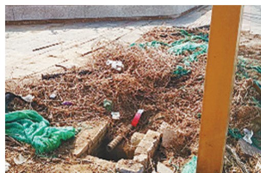
沙湾路与牡丹江路交叉口附近,井盖缺失。
