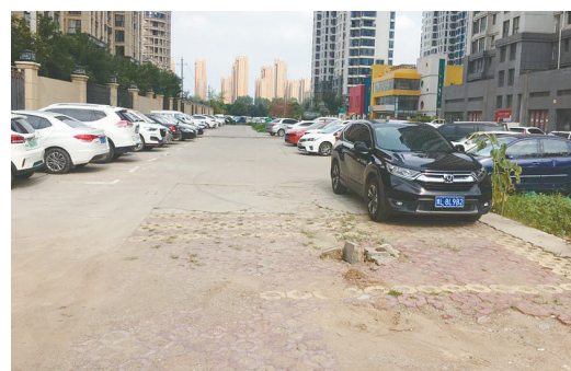
昌建东外滩小区北门,道路坑洼不平。
