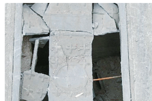
嵩山路与柳江路交叉口附近,井盖破损。
