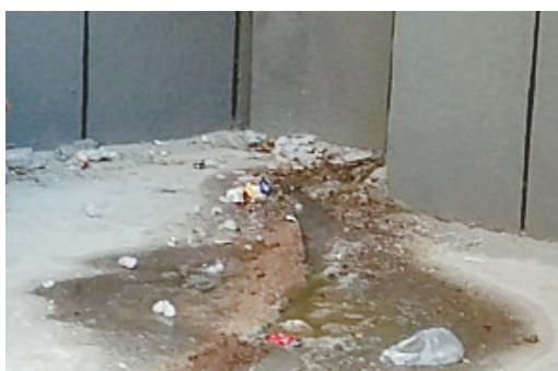
沙北路与支二路交叉口附近,污水外溢。
