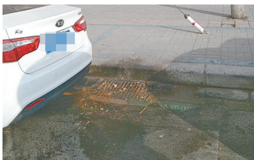
双汇路与入东二巷交叉口东50米路北,下水道堵塞。
