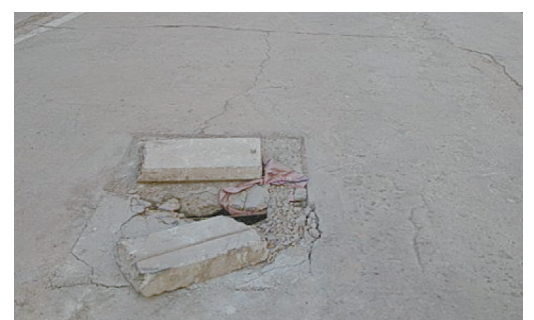
青河路与祁山路交叉口西150米路南,污水盖板破损。
