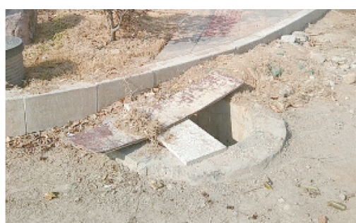
云翠山路与龙江东路交叉口向南100米路西，污水井盖缺失。
