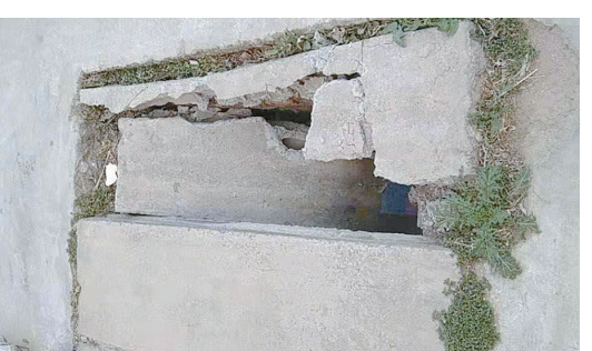
人民东路与庐山路交叉口向东320米路北，污水盖板破损。
