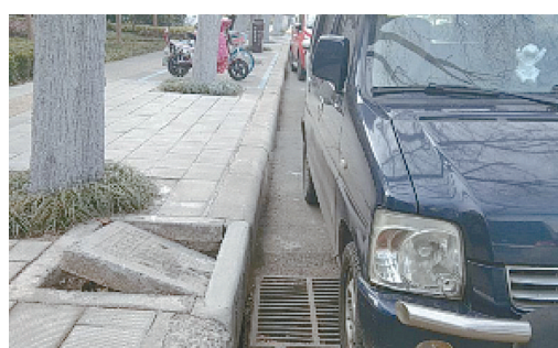
淞江路与舟山路交叉口向西60米路南人行道上，污水井盖下陷。
