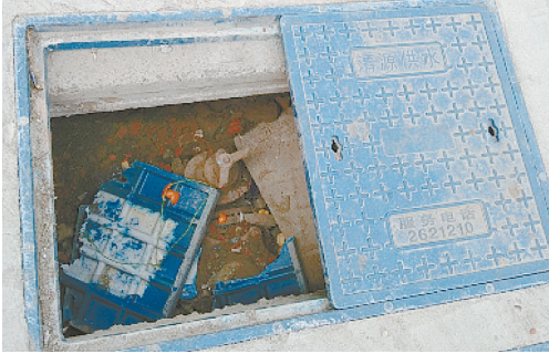
五一路与柳江路交叉口向南约100米路西，窨井盖破损。
