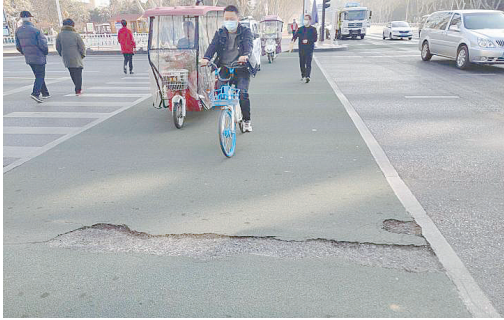
嵩山路与黄河路交叉口北，绿道损坏。
