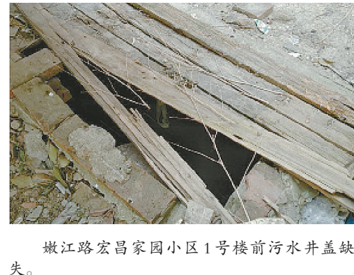
嫩江路宏昌家园小区1号楼前污水井盖缺失。
