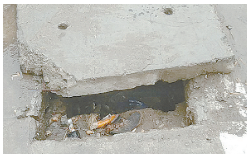
人民东路与庐山路交叉口向东350米路北,污水盖板移位。
