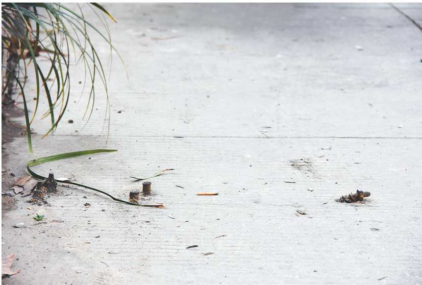
柳江路与嵩山路交叉口附近，围挡拆除后留下的螺丝钉。
