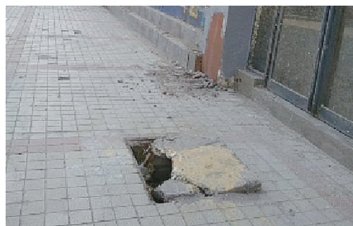
泰山南路与柳江路交叉口向北约50米路西,时代天街门面房前井盖破损。
