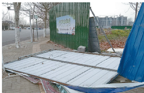
庐山路与黄河东路交叉口向南约20米路西,围挡倒地。
