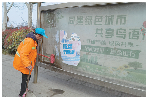
阳山路与人民东路交叉口西北角,宣传栏损坏。
