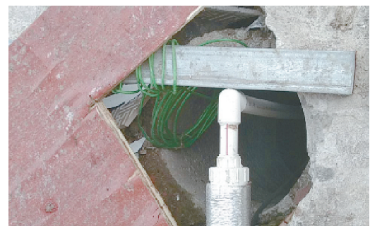
黄河西支路与黄河西路交叉口附近,井盖缺失。
