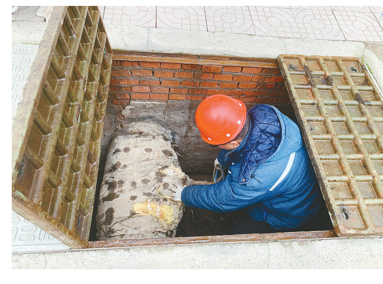
近期,漯河天阳供热公司开展春季安全大检查。图为昨日,在召陵区秀水河路,该公司工作人员对一城供热管网主控制阀门进行检查和维护。
