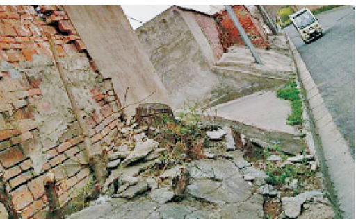
金山南路与滨河东路交叉口向南约80米路西，墙体开裂。
