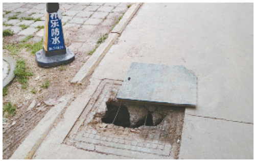
柳江小区13号楼一单元西侧人行道上，污水井盖破损。
