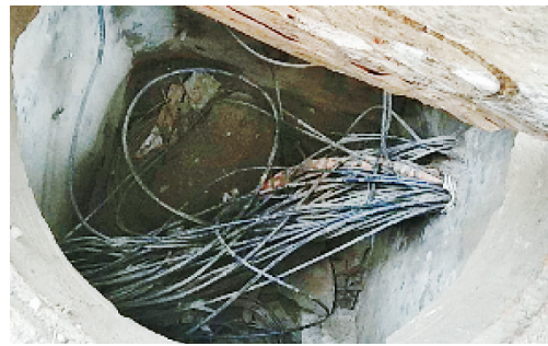
湘江东路与衡山路交叉口向东约30米路南，绿化带内通讯井盖缺失。
