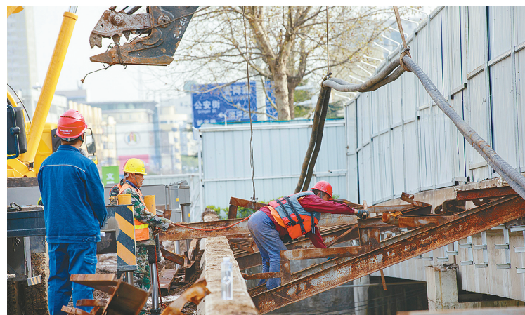
3月28日下午，经过近24小时的紧张施工，国网漯河供电公司顺利完成了10千伏I、II两条出线电缆线路的迁改任务，保障了交通路沙河桥改造工程顺利推进。
