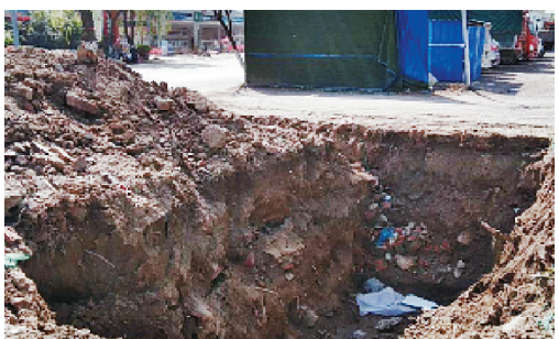
东东北路与汾河路交叉口向北约180米路西，施工方未设围挡也无警示标志。
