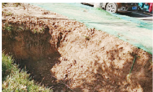
庐山路与汾河路交叉口向北约30米路东，施工方未设围挡也无警示标志。
