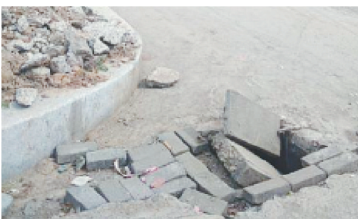
辽河路与太白山北路交叉口向东约20米路南，路面破损。
