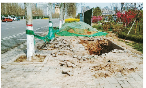
庐山路与渭河路交叉口向北约300米路东，施工方未设围挡也无警示标志。
