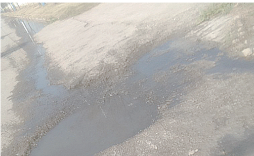
交通南路与银江路交口向南约180米路东,下水道堵塞,污水外溢。
