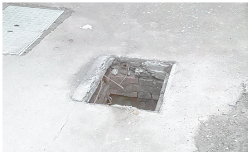
文萃江南小区C号楼三单元门口,窰井盖缺失。
