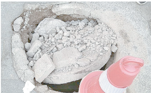
解放南路与八一路交叉口向北约50米路东,窰井盖破损。
