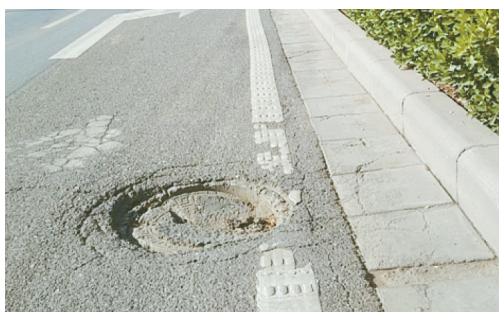
白云山路与湘江路交叉口附近，井盖下陷。
