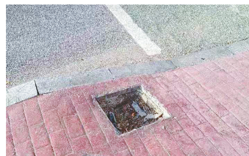
人民路与金山路交叉口附近，路上有个坑。
