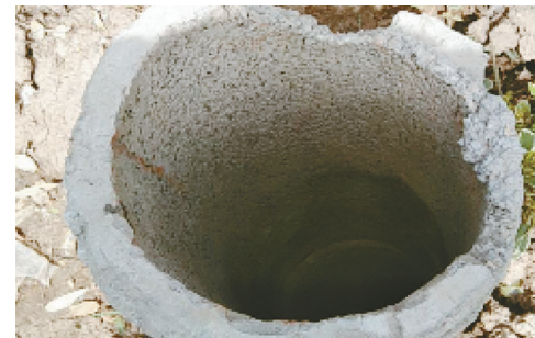
东北北路与黄河东路交叉口向北约50米路东,绿化带内水井井盖缺失。
