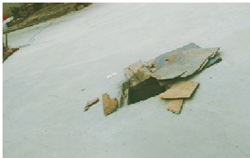
柳江路与交通南路交叉口向西约120米路北,污水井盖缺失,用木板代替。
