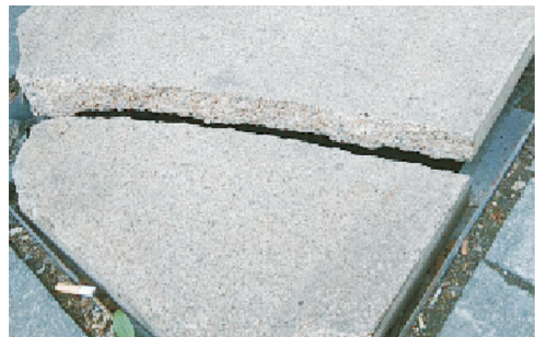
建设路与牛行街交叉口向东约50米路南,人行道污水井盖破损。
