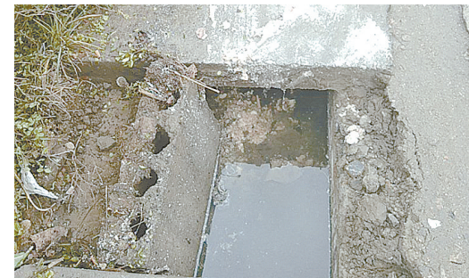
渭河路与银鸽路交叉口向东约260米路北，污水盖板破损。
