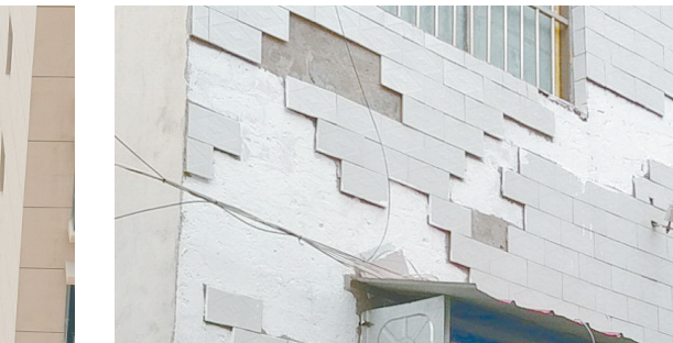
短工市街与民生街交叉口向西约90米路北，楼房外墙瓷砖脱落。
