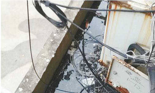
海河路郾城区人民武装部家属楼东单元,楼道口附近排水不畅,雨后经常积水。
