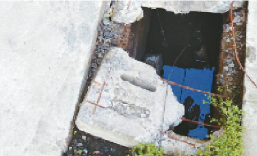
柳江路碑肥家属院1号楼二单元西侧,雨水算子破损。
