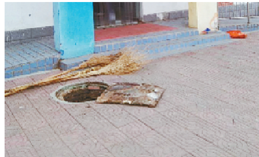
龙江东路与中山北路交叉口向东约330米路北,井盖缺失。
