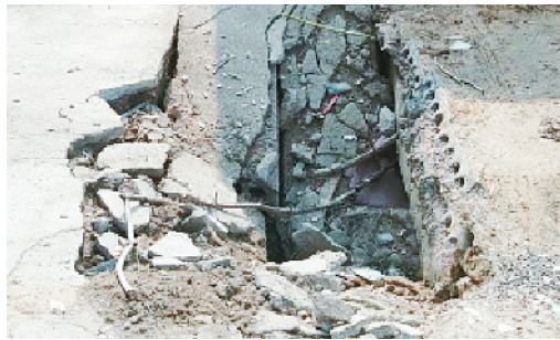
祁山路与淞江路交叉口向北约70米路东,污水盖板下陷。
