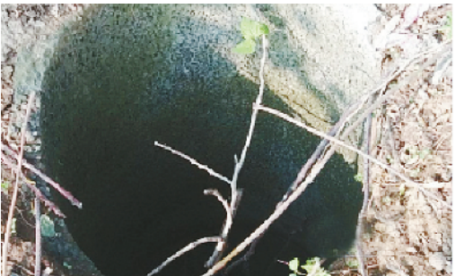
黄河东路与玉山路交叉口向东约200米路东,井盖缺失。
