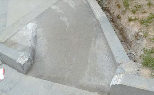
MOCO新世界小区，无障碍通道设置不合理。
