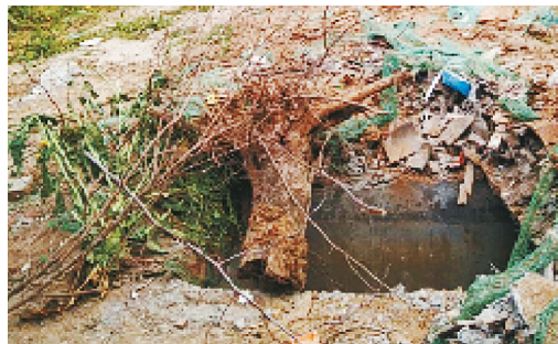
金江路与文化路交叉口向西约60米路北,窨井盖缺失。
