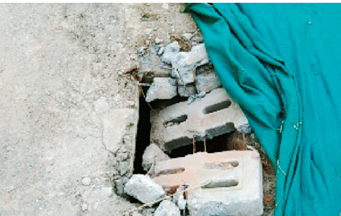
建设路与文化路交叉口附近，窨井盖破损。
