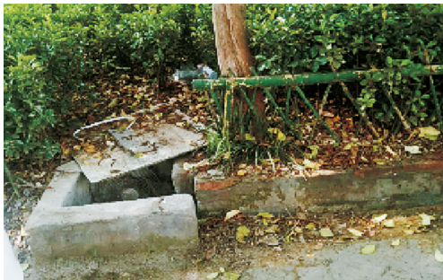
黄河路与邛山路交叉口附近，窨井盖缺失。
