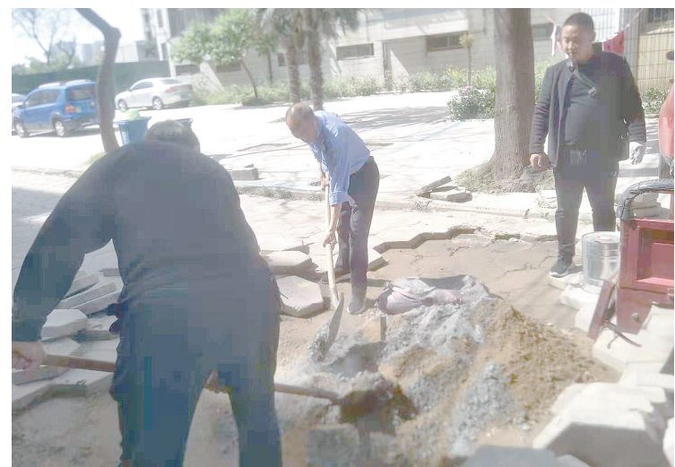
近期,淞江小区部分路面地砖由于老化出现开裂,龙塔街道淞江社区协调人员对破损路面进行了修补。 见习记者 刘净涛 摄
