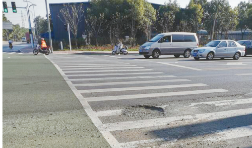
人民路与阿里山路交叉口，路面坑坑洼洼。
