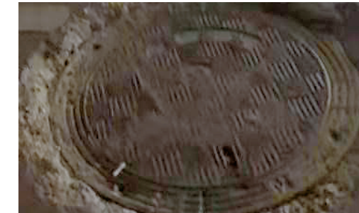
祁山路与淞江路交叉口，窞井盖下陷。
