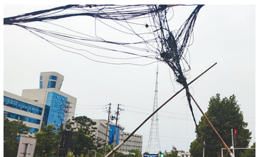
太行山路和海河路交叉口附近,线缆杂乱存在隐患。
