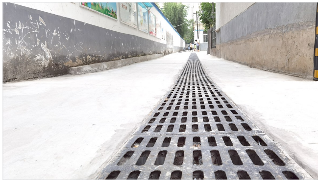
小区内的雨水收集系统。
