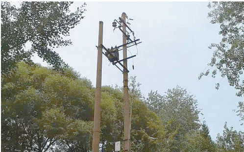
嵩山路沙河桥南，废弃线杆未处理。
