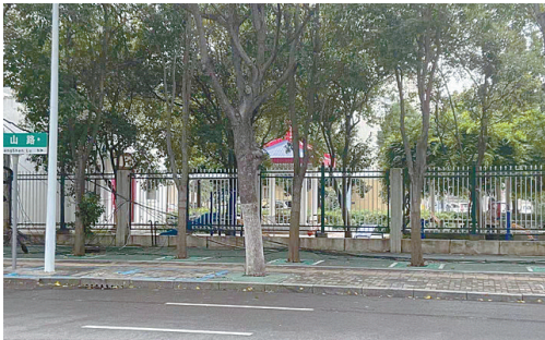
黄山路（黄河路至海河路段）西侧，线缆垂地，无人处理。
