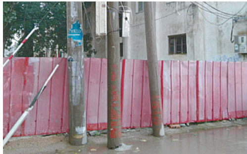
汉江路与伏牛山路交叉口附近，线杆底部断裂。
