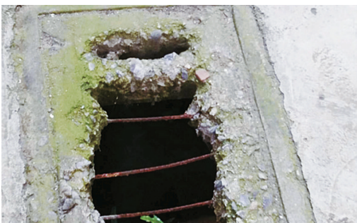
太行山南路与桂江路交叉口附近，窨井盖破损。
