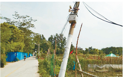
黄河路与滨河东路交叉口向东约80米路南，线杆倾斜。
