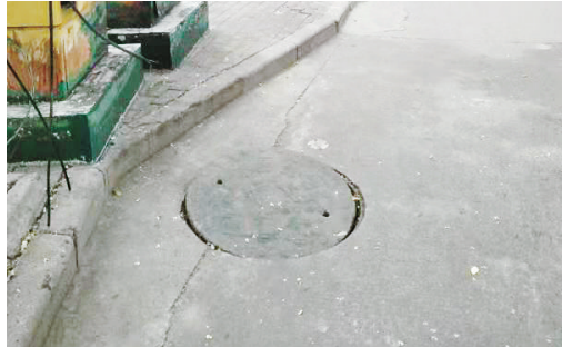
泰山北路与海河路交叉口向北约5米路西,井盖下陷。
