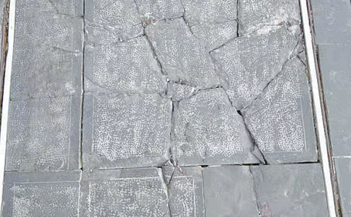
泰山南路与银江路交叉向北约70米路西,人行道井盖破损。
