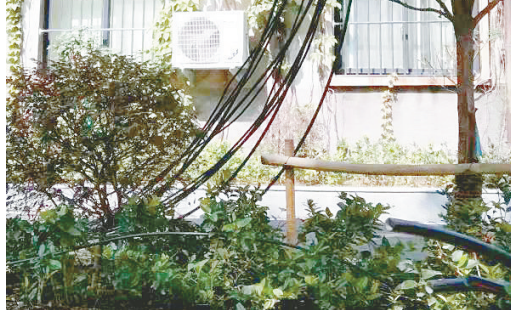
祁山路与海河路交叉口向北约50米路西，绿化带内线缆垂落。
